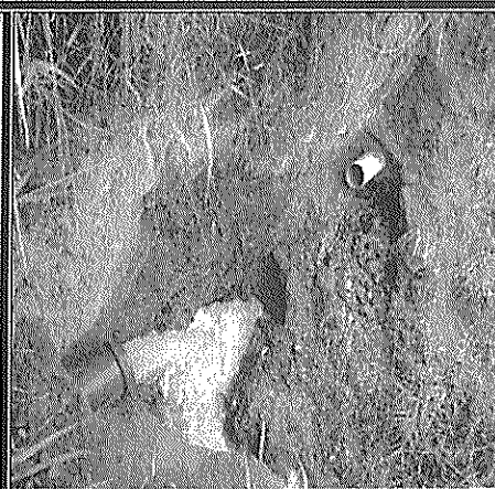
FOTO N°08: Colapso de la red principal de alcantarillado producto del desborde de tierra, por causa de las intensas lluvias, ubicado en el sector Chililique, San Ignacio – Año 2020
