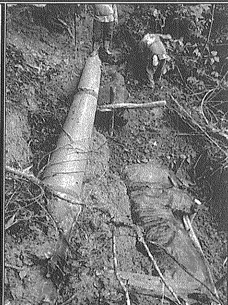
FOTO N°06: Derrumbes de cerros inestables ante las intensas lluvias en el caserío El Tunal, el cual dejó en mal estado la Línea de Conducción – Año 2021
