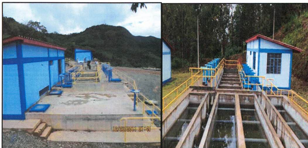
Figura 13. PTAP San Juan - Nueva
