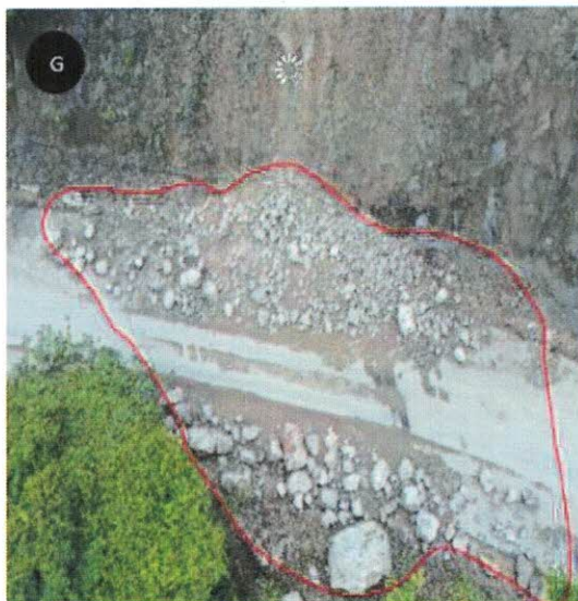
Figura 5. Obstrucción de vías
