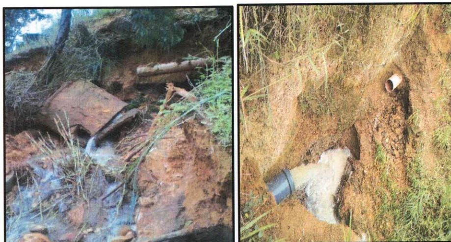
Figura 22. Colapso de colectores principales
