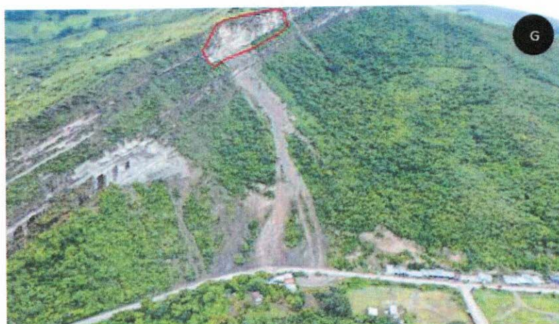
Figura 4. Derrumbe en km 81 de la carretera Jaén a San Ignacio
